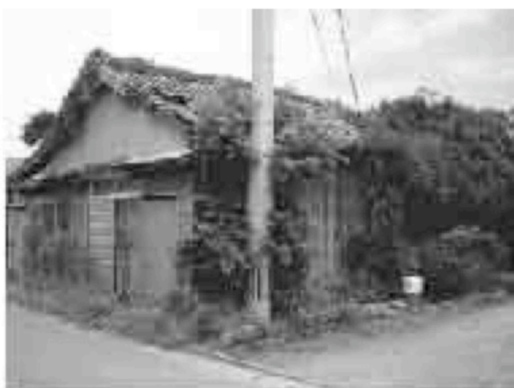
長期間管理されない土地と建物
