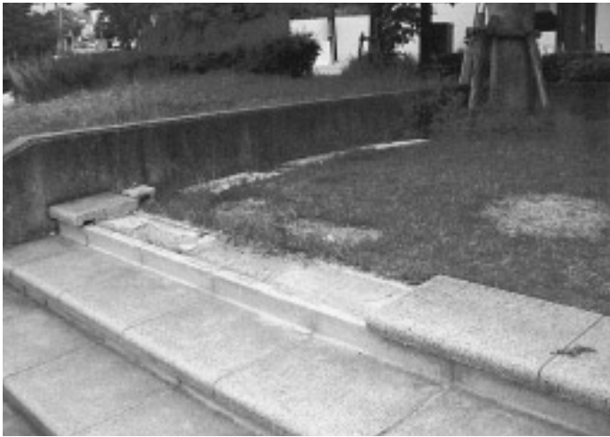
破損した階段(井原堤水辺公園にて)
