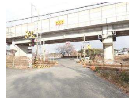
拡幅予定の井原踏切
