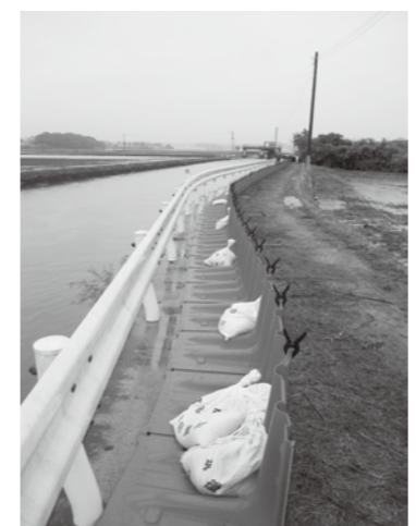
堤防に設置された簡易型止水パネル
