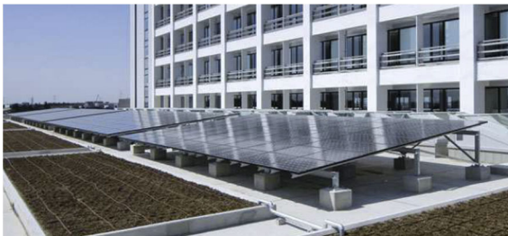
太陽光発電パネル（つくば市庁舎）
