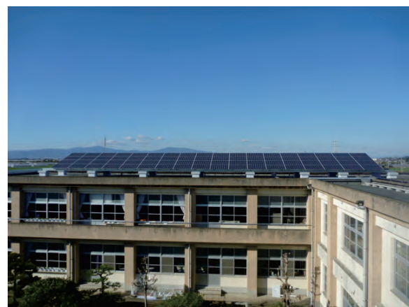
小学校に設置された太陽光パネル
