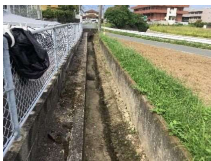
水が全く流れていない水路
